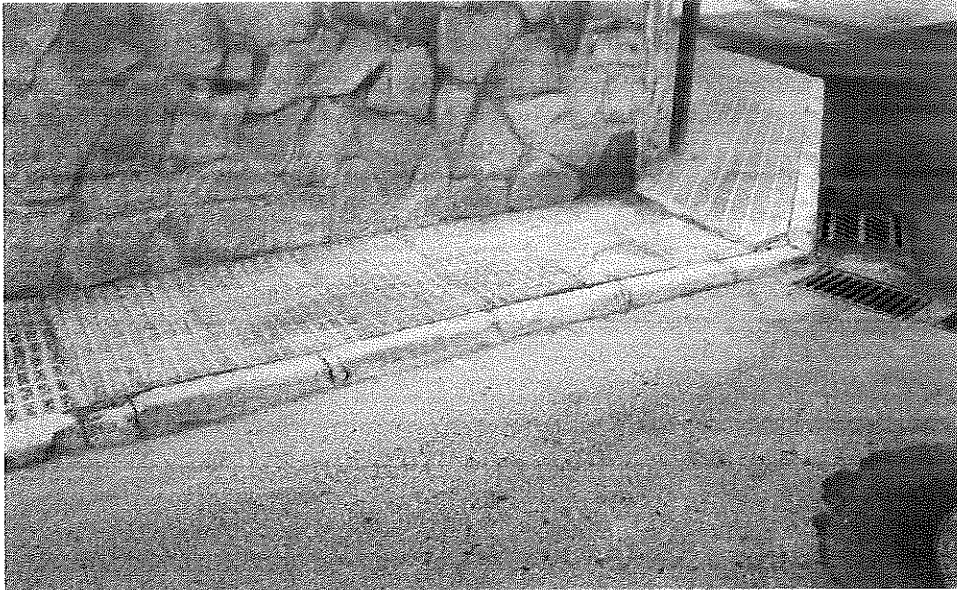
Calle Fuensanta, Zarandona, Murcia, rotura de Acera.
