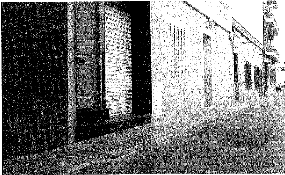
Calle Fuensanta nº 5-A, Zarandona, Murcia, Acera hundida.
