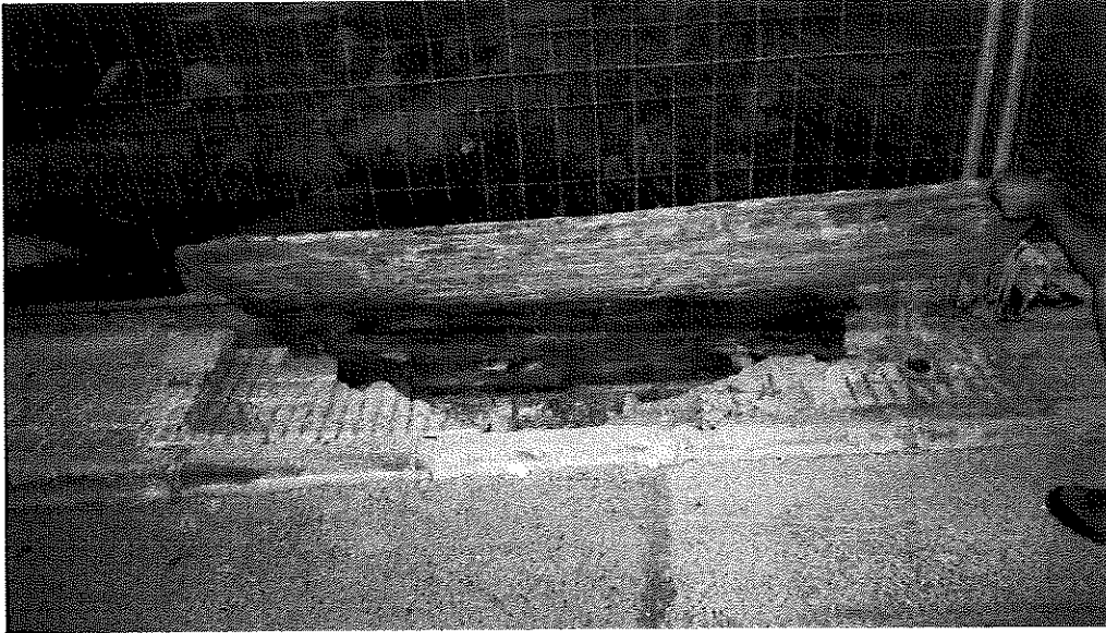
Calle Santiago,nº 3-9, Zarandona, Murcia, Acera rota tapada con un tablero.
